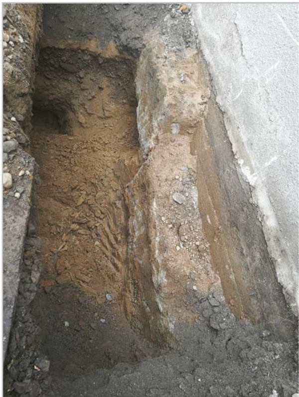
Kuva 1. KK1 betonin alapuolella ei havaittavissa sokkelia. Betonin paksuus 0,45 m. Alla erittäin tiivis savinen siltti.
