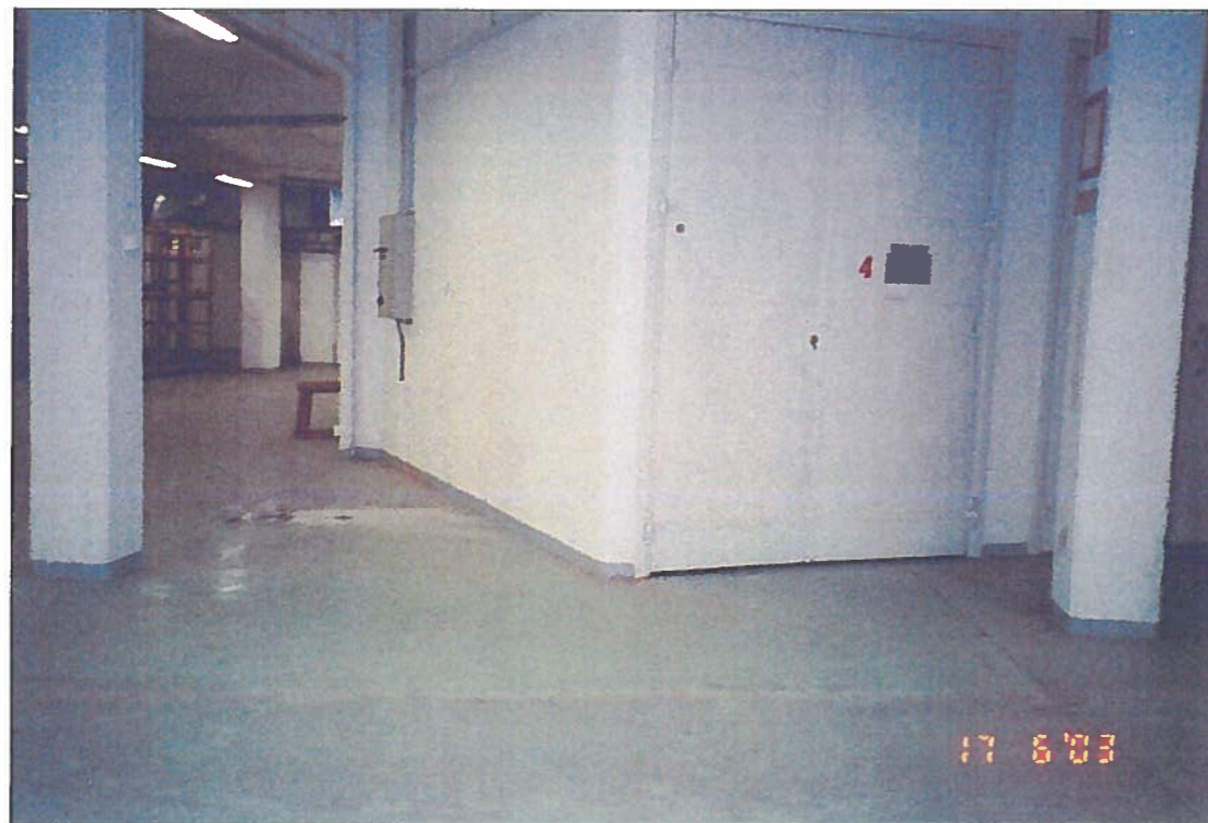
Kuva 8. Tutkimuspiste S32 maanalaisessa kellarissa, muuntamot oikealla.
